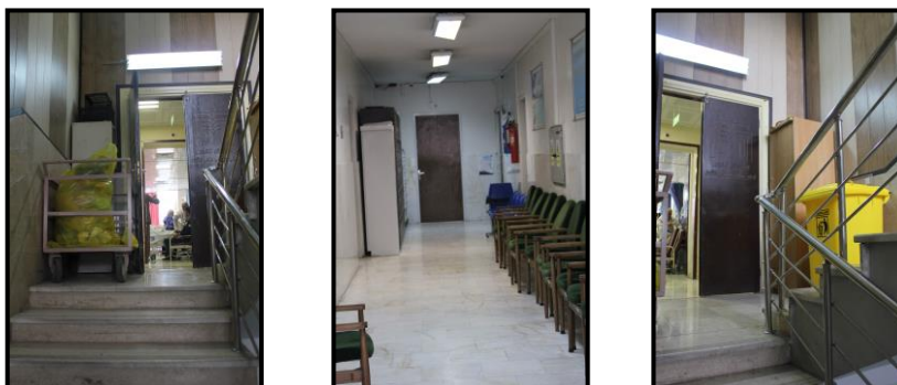
شکل ۶: مسدود بودن راه های خروج اضطراری
